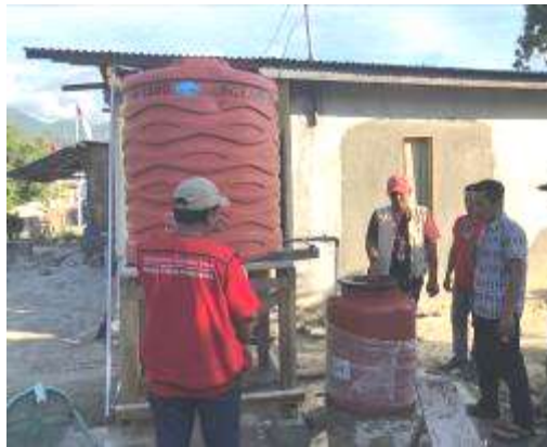
水源設施過濾系統
