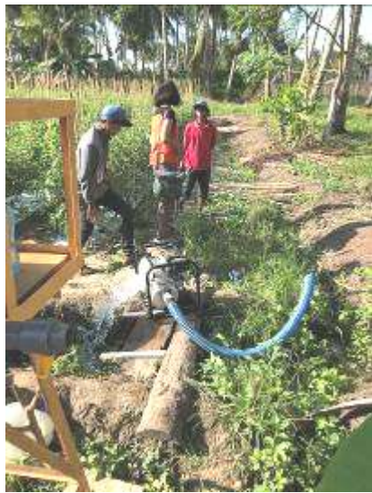
抽水機運作照片
