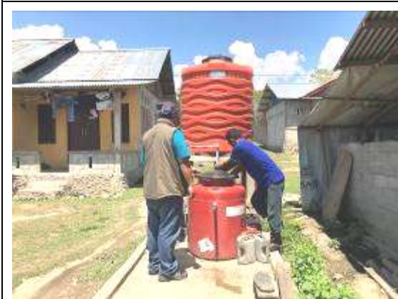
水源設施過濾系統
