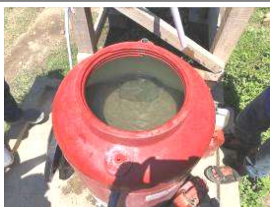
水源設施過濾系統內部
