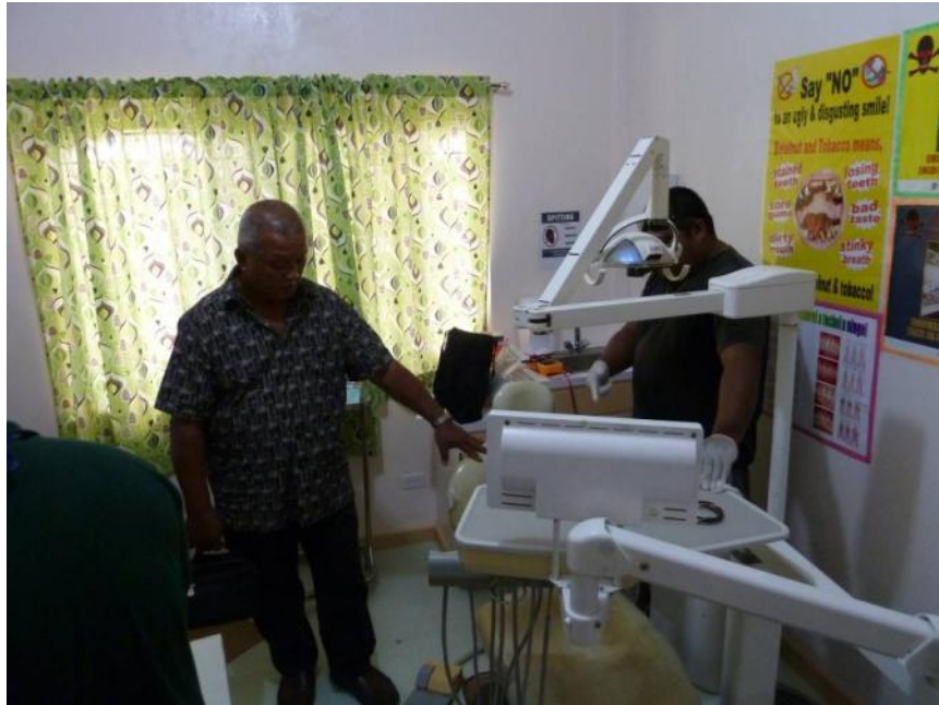
照片 12 牙科椅安裝場地
