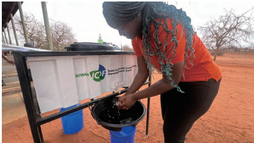
國合會「肯亞加里薩縣脆弱社區衛生機構基礎供水與衛生 (WASH) 可近性提升計畫」協助衛生照護機構設置洗手設置，以確保醫護人員與病患手部清潔。
