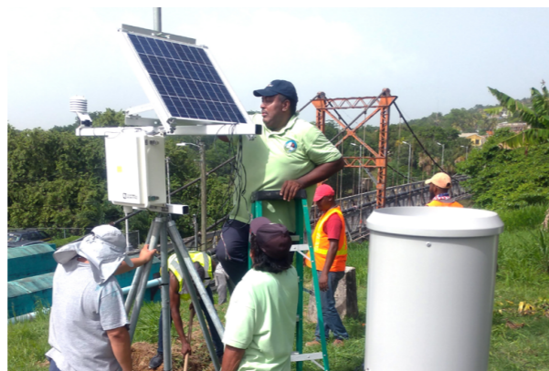
El proyecto hizo uso del sistema de alerta temprana ante inundaciones y del Internet de las cosas para emitir una advertencia temprana, concediendo un tiempo de evacuación de alerta temprana de 3 horas a los ciudadanos de San Ignacio.
