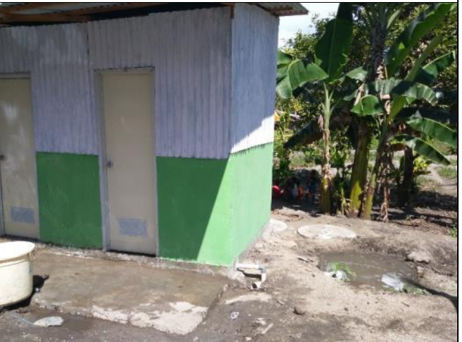
社區內之公廁(尚未加裝沖水設備，且洗手後之之廢水直接排入窪地，容易危害環境。
