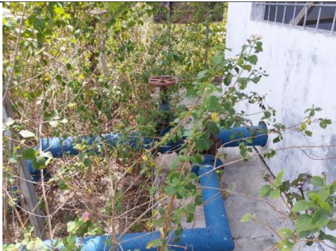
抽水機之進水口
