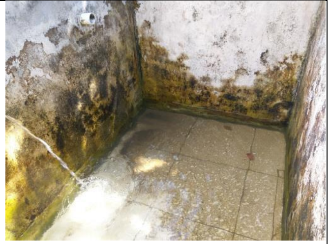
社區儲水槽內觀，已有部分淤積，且上方沒有加蓋。
