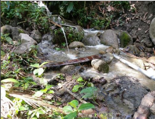
社區水源簡易取水口(無加裝濾網，沙石容易進入水管，管線為地震後居民自行裝設。
